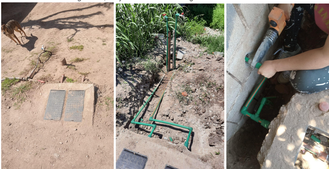
Figura 19, 20 y 21. Conexión de Agua Intradomiciliaria
