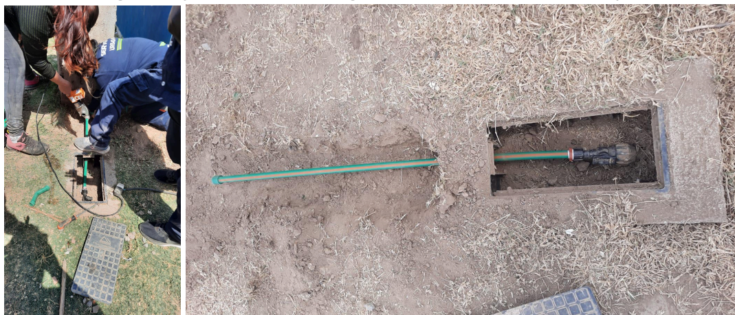
Figura 14 y 15. Conexión de Aguas Cordobesas a Línea Municipal.
