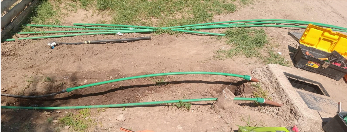
Figura 22. Conexión de Agua Intradomiciliaria.
