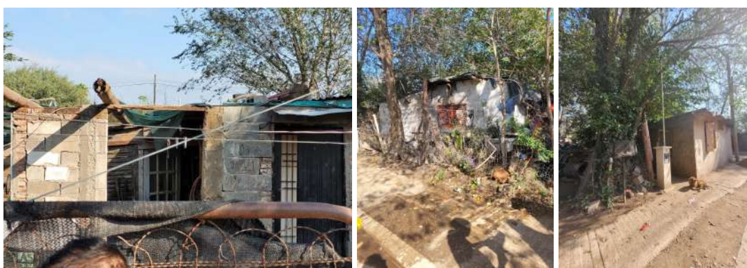
Imagen 16, 17 y 18- Situación general de las condiciones de las viviendas.
