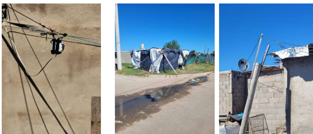
Fotos propias de casillas y de conexiones irregulares en Cabildo Anexo.
