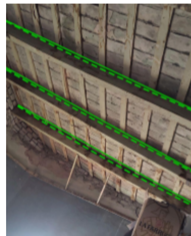
Gráfico N°7: Registro fotográfico evidenciando la deformada de las cabriadas.
