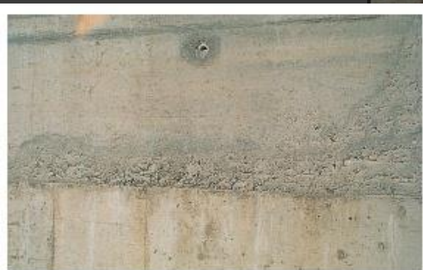
FIG. 3.1.1 Nidos de abeja formados como consecuencia de una altura de caída excesiva, o también por una armadura muy densa.
