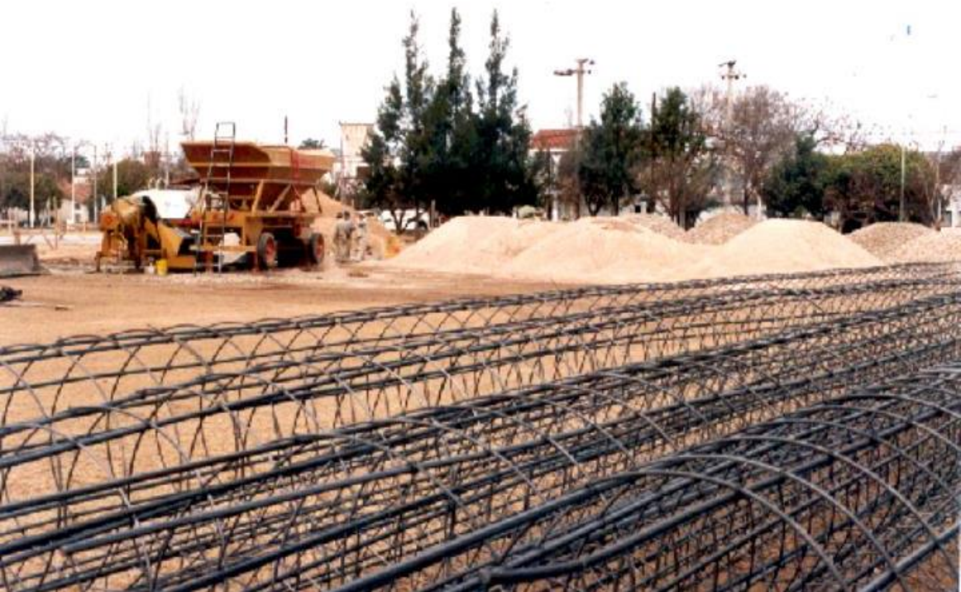
Planta hormigonera en obrador
