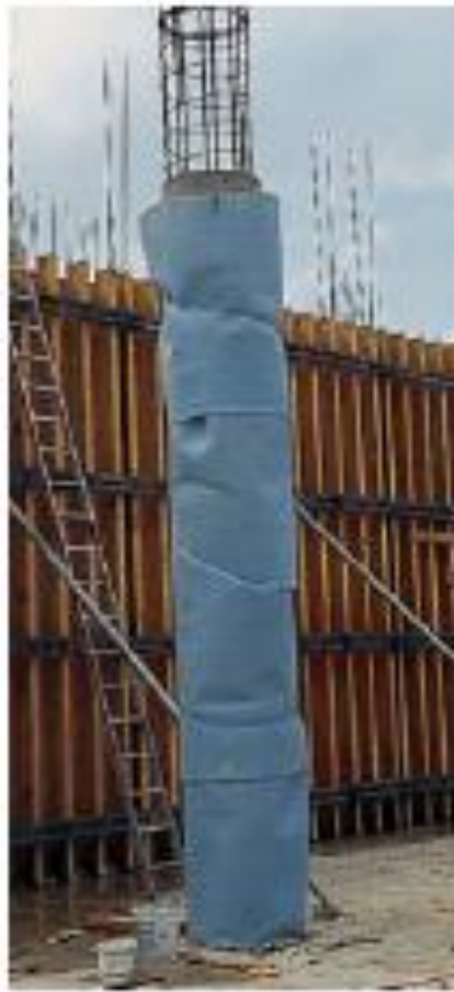
FIG. 2.5.2 Protección aislante de una pilastra
