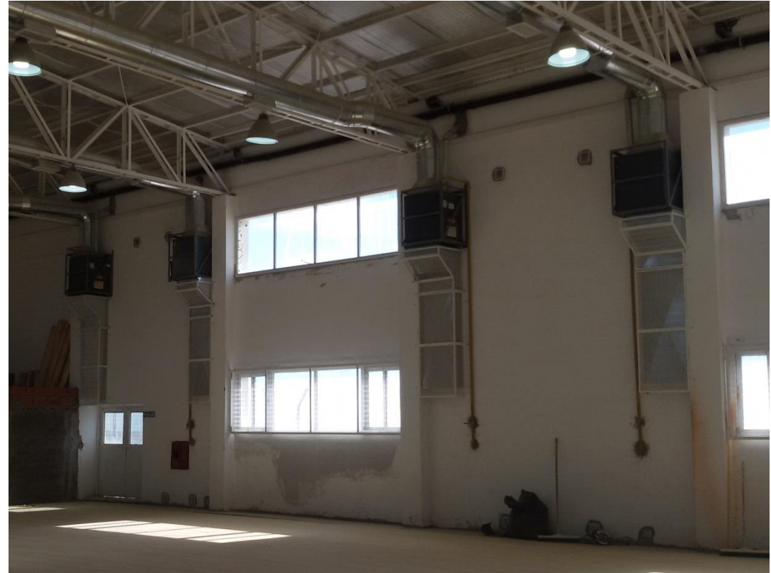
EQUIPOS DE CLIMATIZACIÓN EN POLIDEPORTIVO
