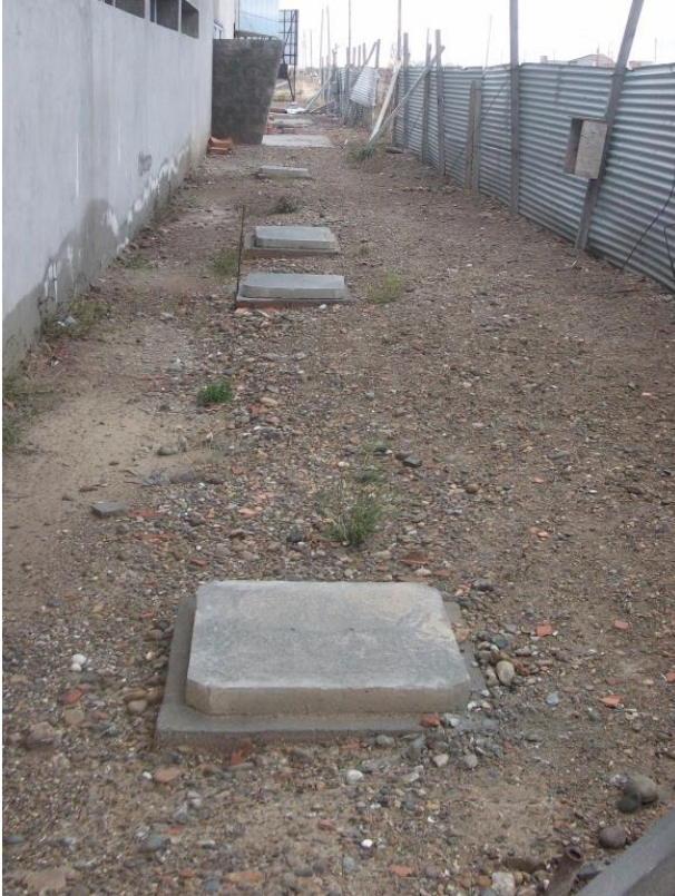
BATERÍA DE CÁMARAS DE INSPECCIÓN PARA FACILITAR EL MANTENIMIENTO DE SANITARIOS
