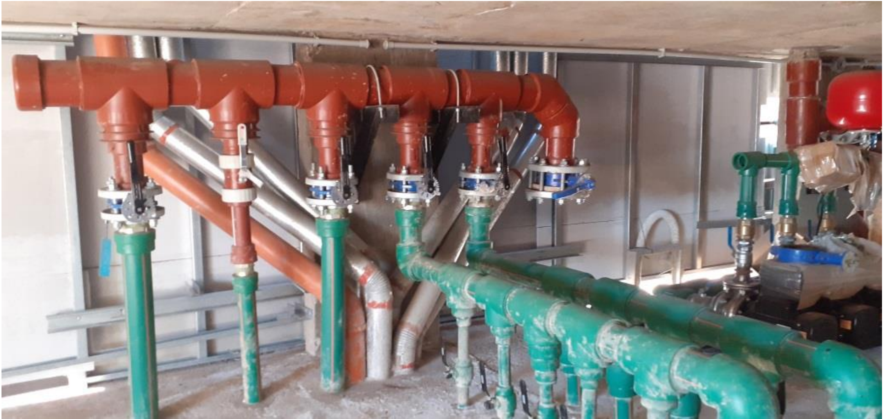
COLECTOR DE TANQUES
