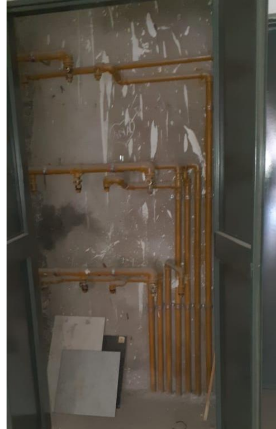
Cañerías para medidores en palier
