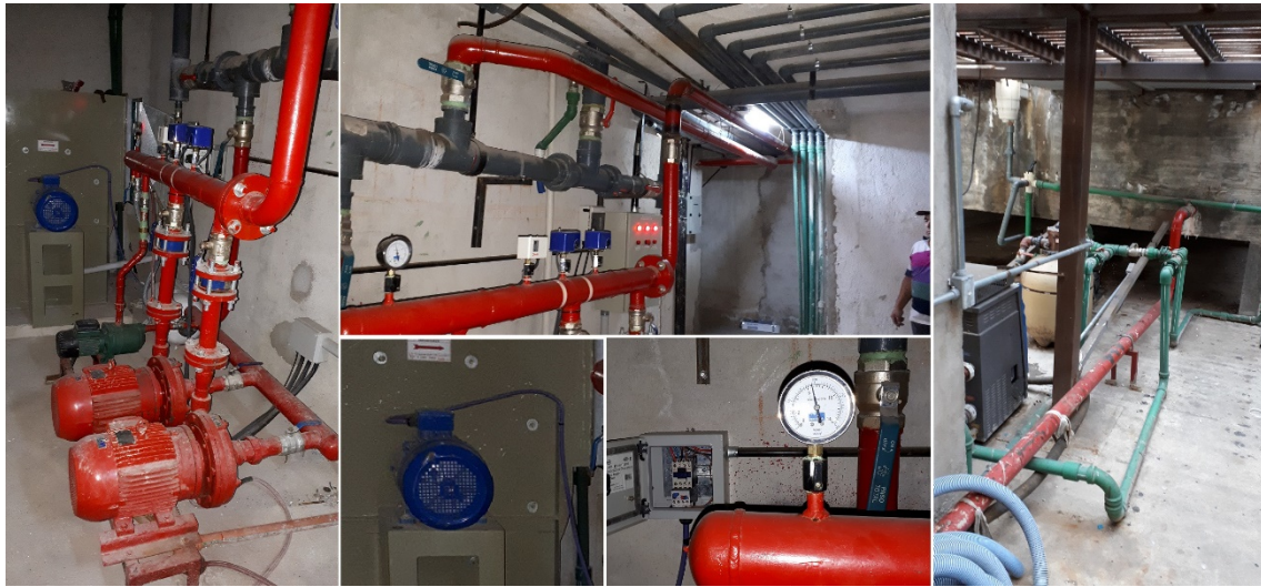
Sala de bombas sistema contra incendio. Presurizador
